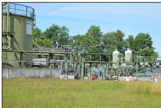
Afbeelding 2.7. Gasleidingen op terrein.
