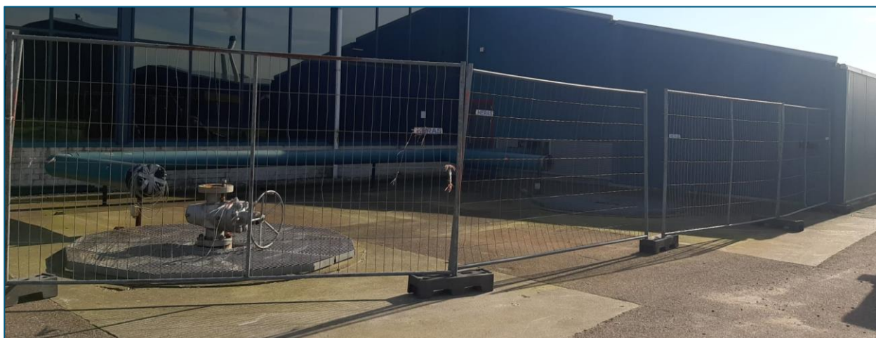
Figuur 2-8. De pompinstallatie van de geothermie op locatie 3. Foto: Royal HaskoningDHV, 2022.
