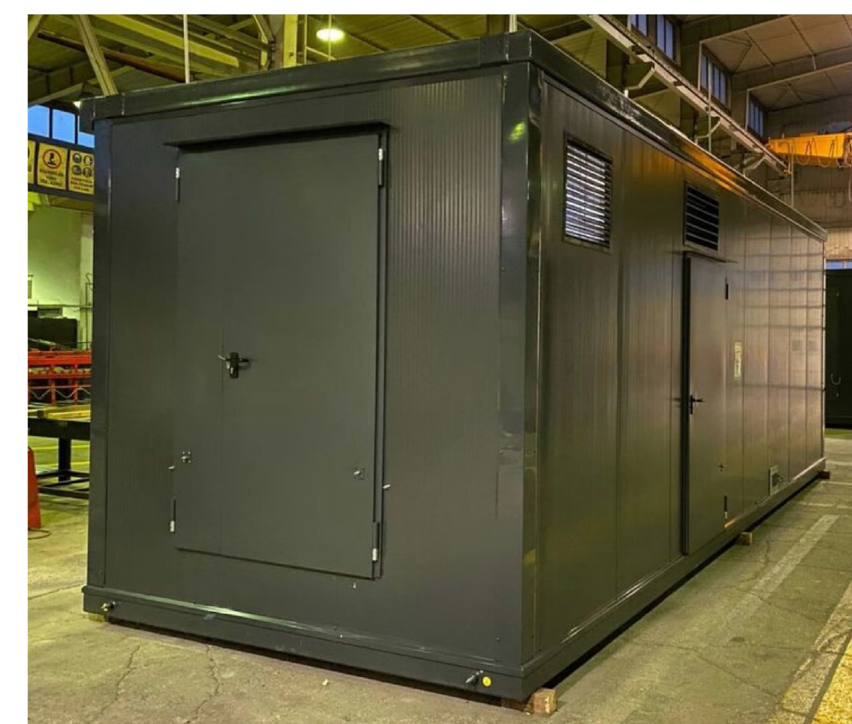
SUBSTATION ZOALS REEDS GEBOUWD
